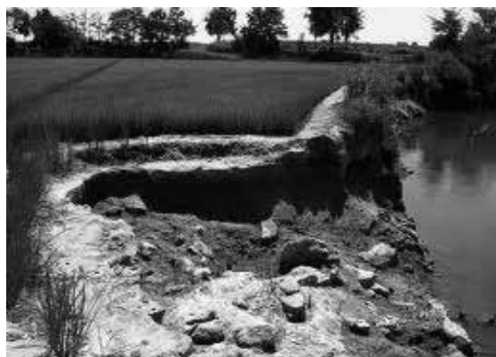
Fig. 18 cedimento di un argine. Tratto da http://ilpiccolo.gelocal.it
